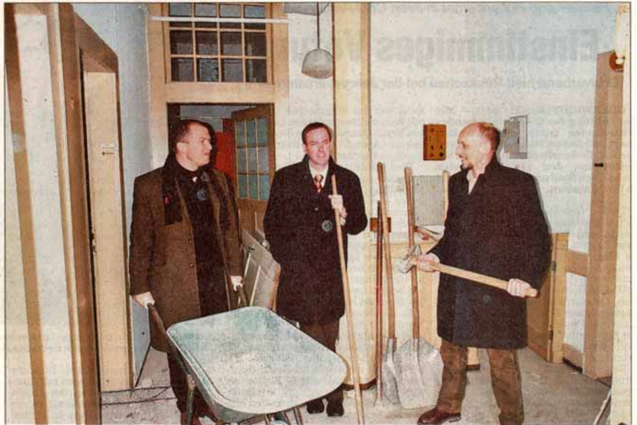
Während Handwerker alte Trennwände und die frühere Badinstallation entfernen, greifen (von links) Stadtbaumeister Holger Göttler, Oberbürgermeister Dr. Christoph Hammer und Theaterintendant Peter Cahn eher symbolisch zu Hammer, Schubkarre und Besen in der künftigen Theaterscheune. Foto: Loy
